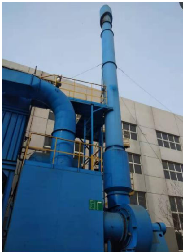
抛丸废气排放口
