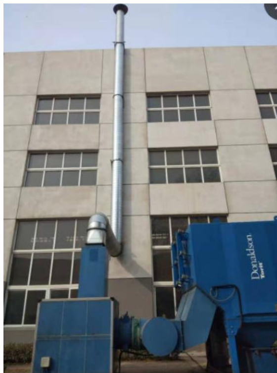
B 车间切割废气排放口
