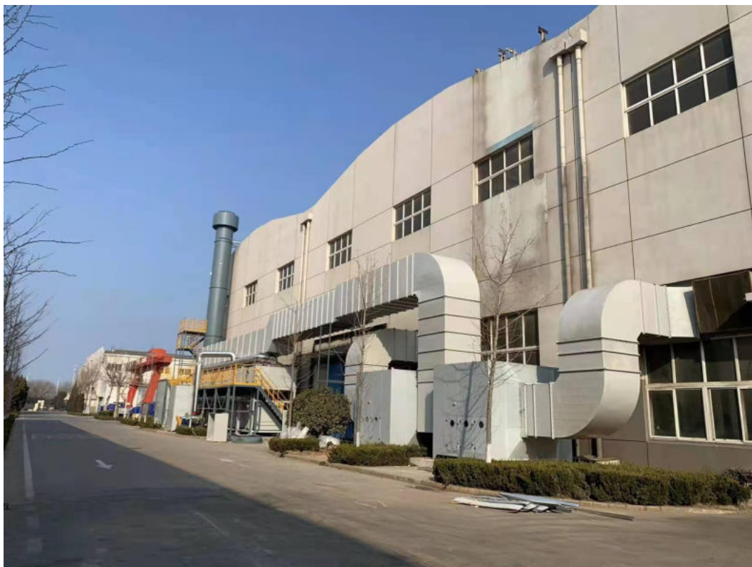
B 车间喷漆废气排放口
